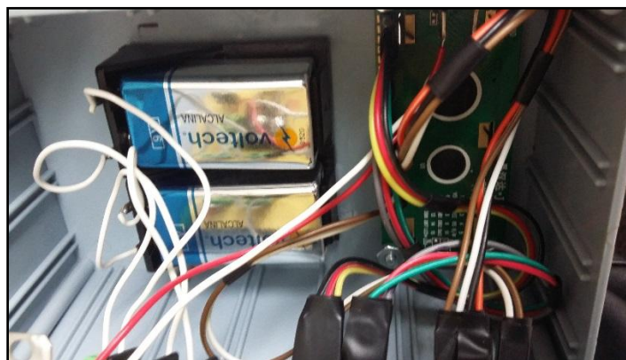
Figura 5: Alimentación y LCD para despliegue de datos montada sobre contenedor del sistema.
